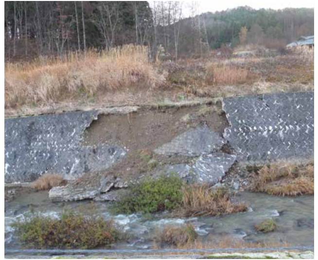
姫川に崩れ落ちた右岸の護岸ブロック
