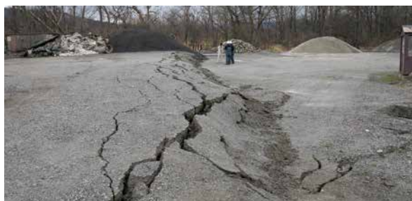
写真2 建設会社の敷地に現れた神城断層による撓曲（塩島区）
