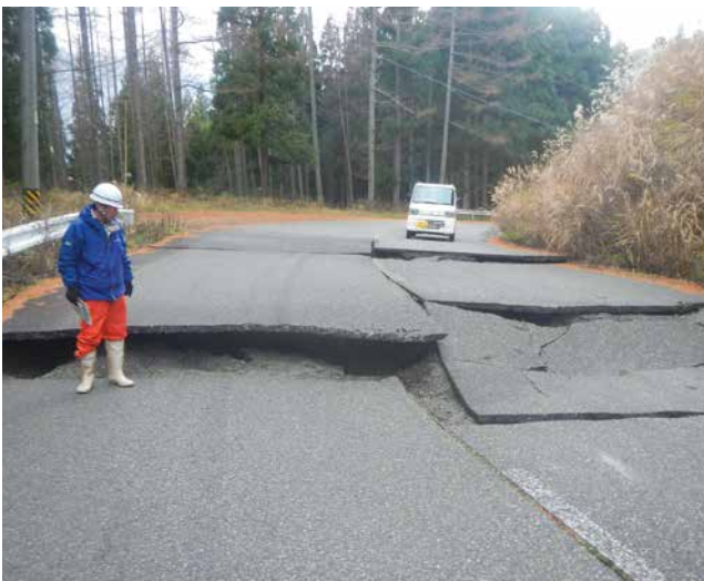
林道白沢線では、白沢地先で大きな亀裂・段差が発生
