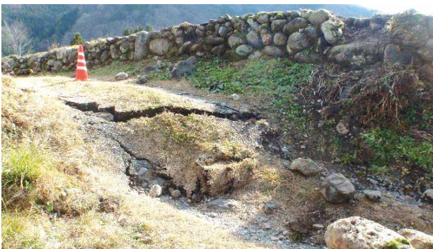
農道の路面が大きく隆起。東側が約95cm隆起、左方向に約35cmのずれ(大字区)
