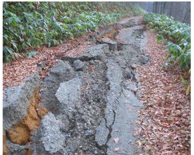
林道郷尺窪線は嶺方で大きく崩落
