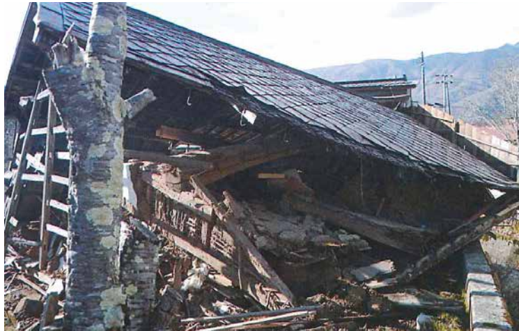
倒壊した土蔵（堀之内区）
