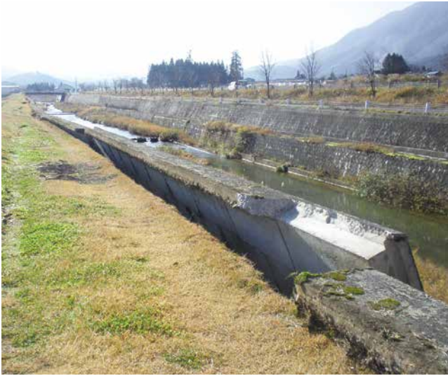
大きく破損した姫川右岸の護岸ブロック
