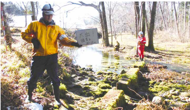
陥没した頭首工(取水口)(大字区)
