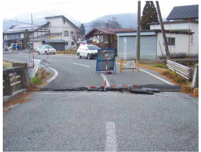
損傷し、通行止めとなった国道406号天神宮橋
