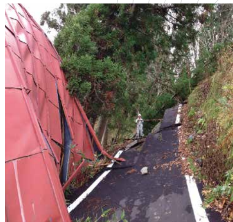
地すべりにより道路とともに押しつぶされた民家（八方岩集落）
