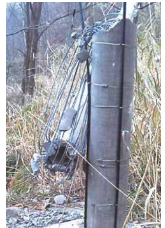
破損した電柱
