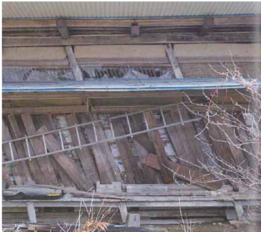
大きく傾いた主屋（堀之内区）
