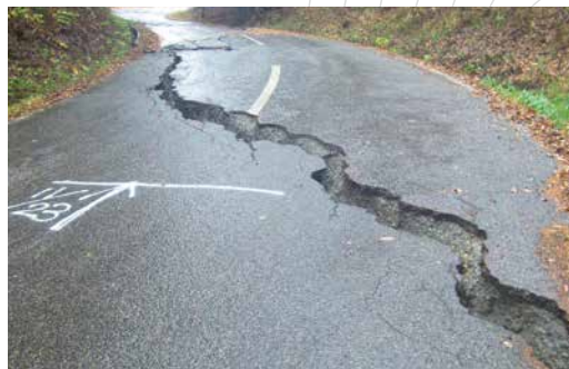
国道406号は、嶺方区堀田で路面に大きな亀裂
