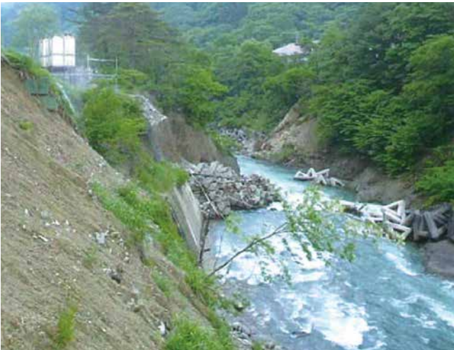
姫川第二ダム下流では河岸が崩落
