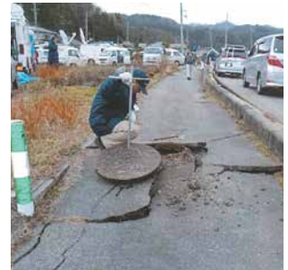
浮き上がったマンホール（大出区）
