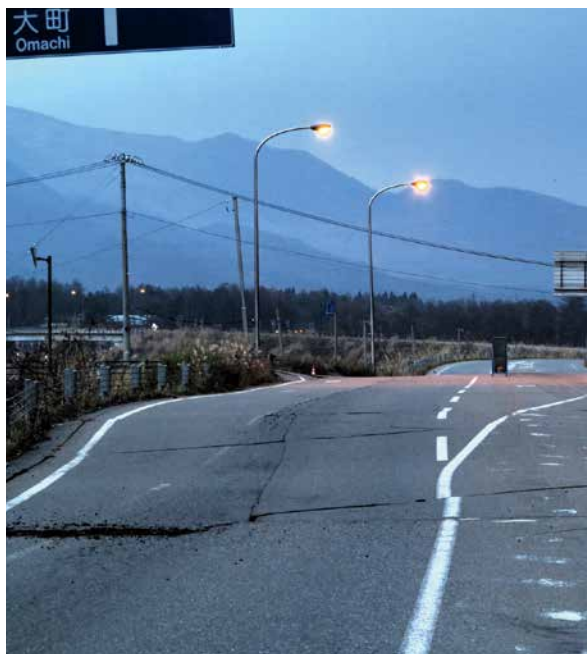
写真6 県道33号（白馬美麻線）に現れた断層
