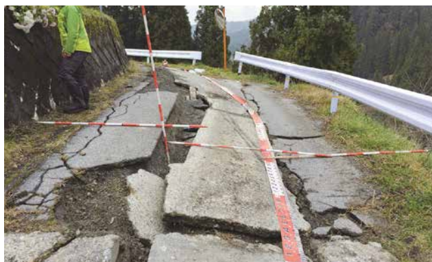
村道戸石線では段差・陥没が多数発生
