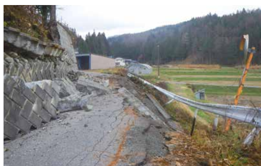
北谷地では村道ののり面のブロックが押し出されるように崩壊（堀之内区）
