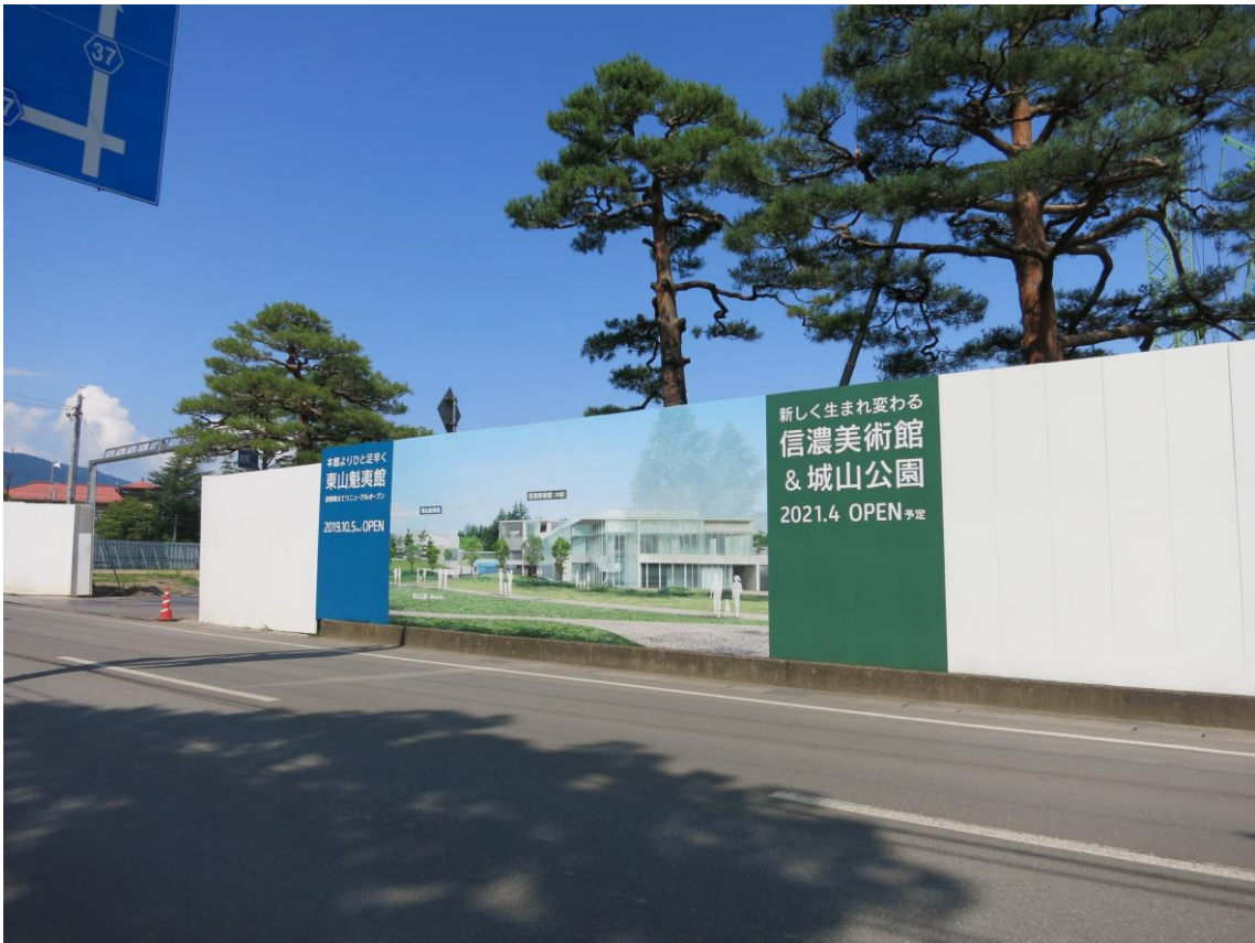
D 仮囲い（グラフィック表示）
