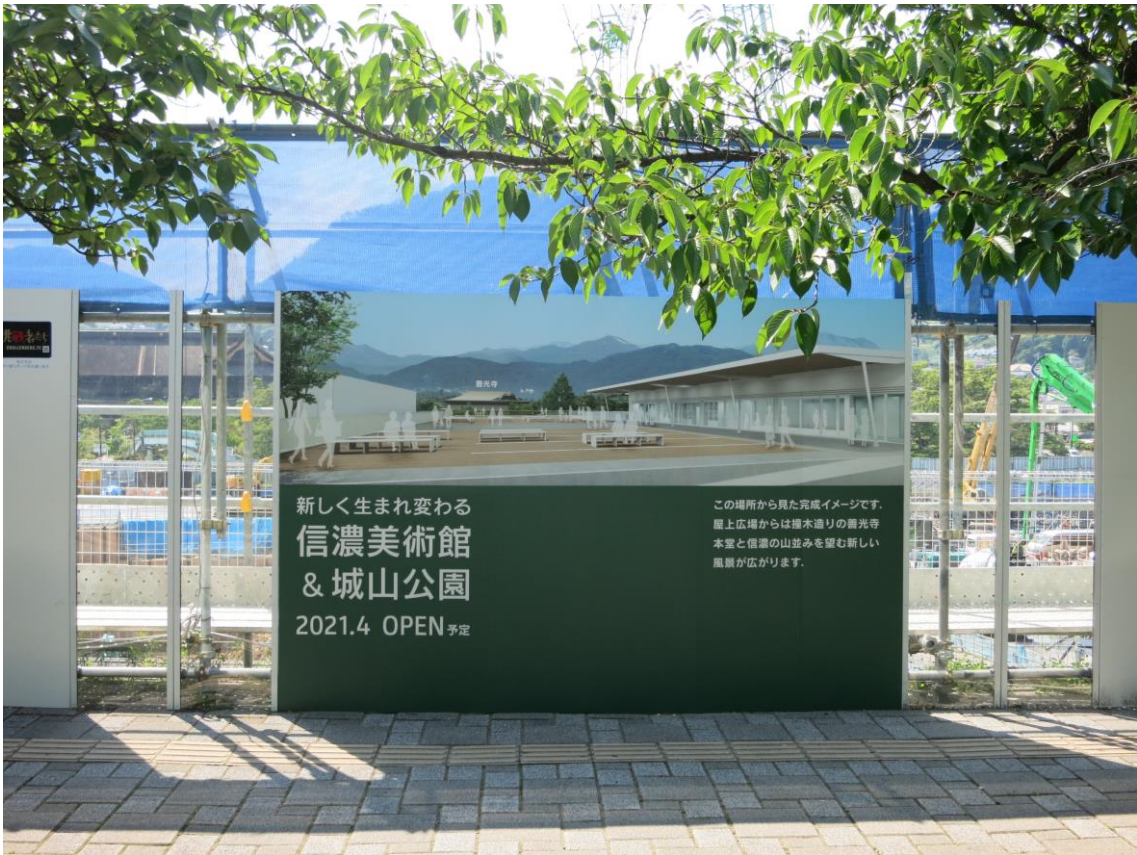
B 仮囲い（グラフィック表示+両側透明パネル）
