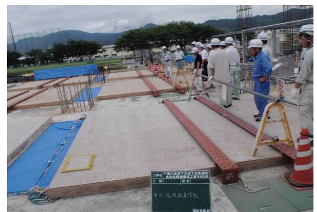
▲最終沈殿池水槽への落下防止対策
