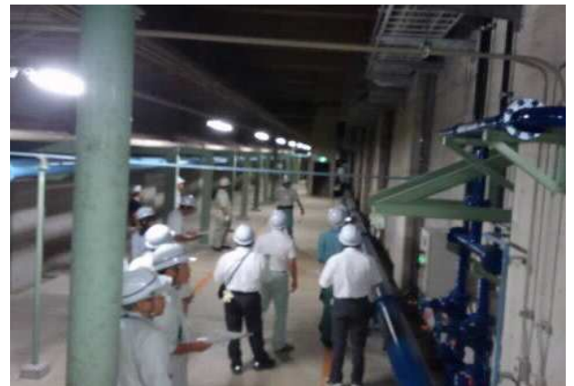
▲水処理棟内の管廊
