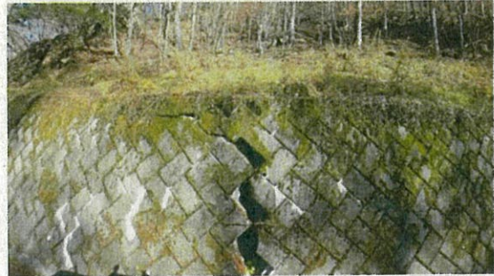
図-5 インターバルカメラにより移動撮影した擁壁の破損
