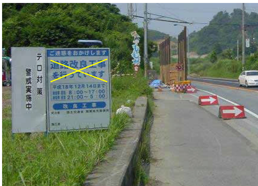
○工事中看板の工事目的が、具体的でなく判りにくい。
