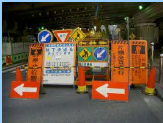
多種類の路上工事看板が乱立しており、中には重複した看板もある。
