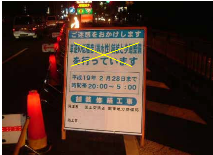
○工事中看板の工事目的が、簡潔でなく判りにくい。
