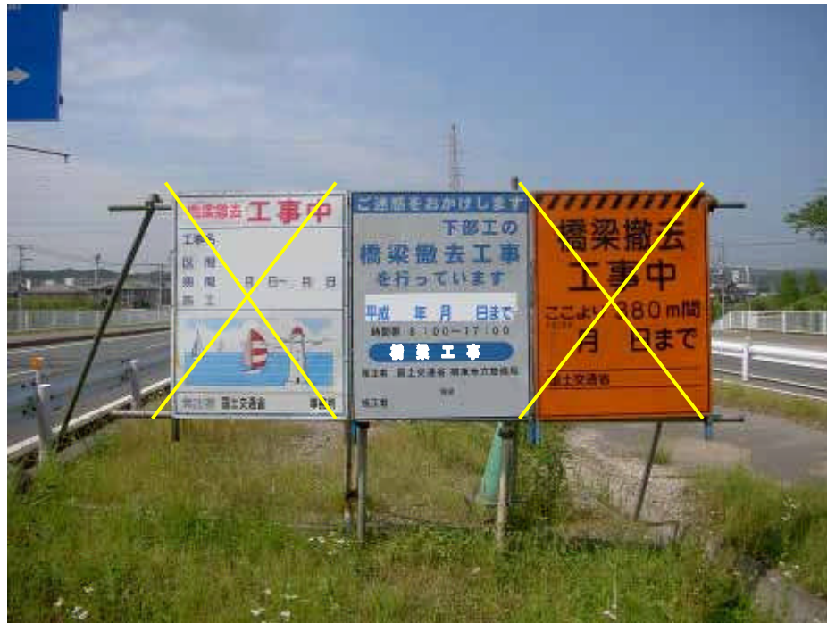
○工事中看板（新しい工事標示板）と一緒に、従来の工事標示板と工事標示板（補助）が設置されている。
