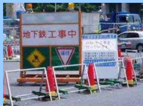
占用工事とわかるように「地下鉄工事中」と表示している。
