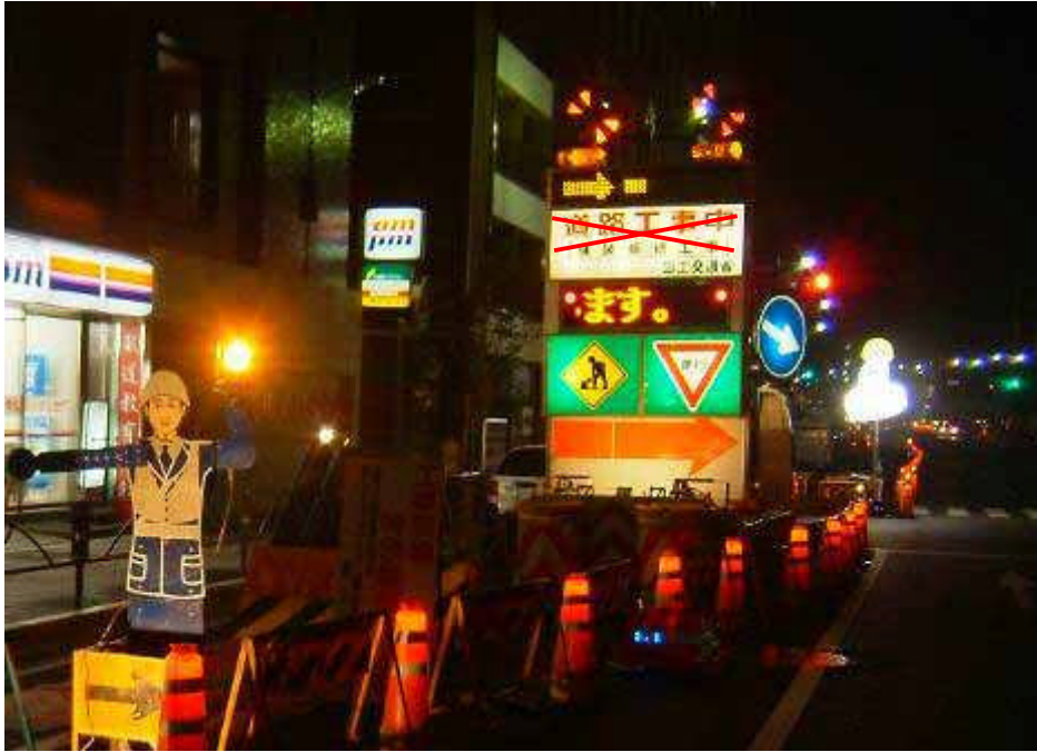
○工事中（内部照明型）標示板の工事種別の表示が「舗装工事中」ではなく、「道路工事中」と標示されている。
