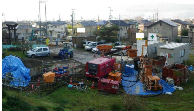
実際に設置したプラント
