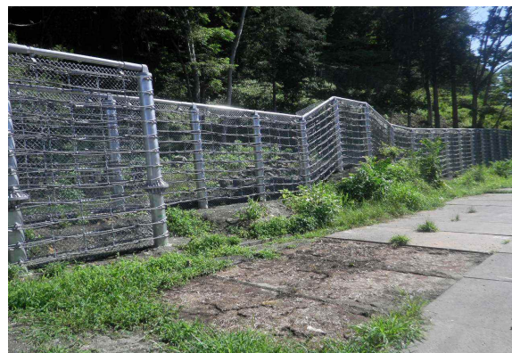
3号崩壊土砂防止柵
