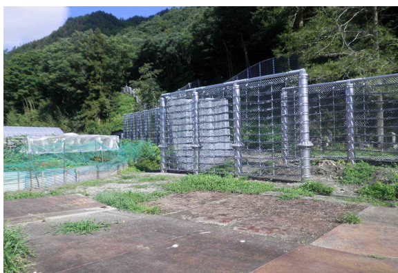
2号崩壊土砂防止柵
