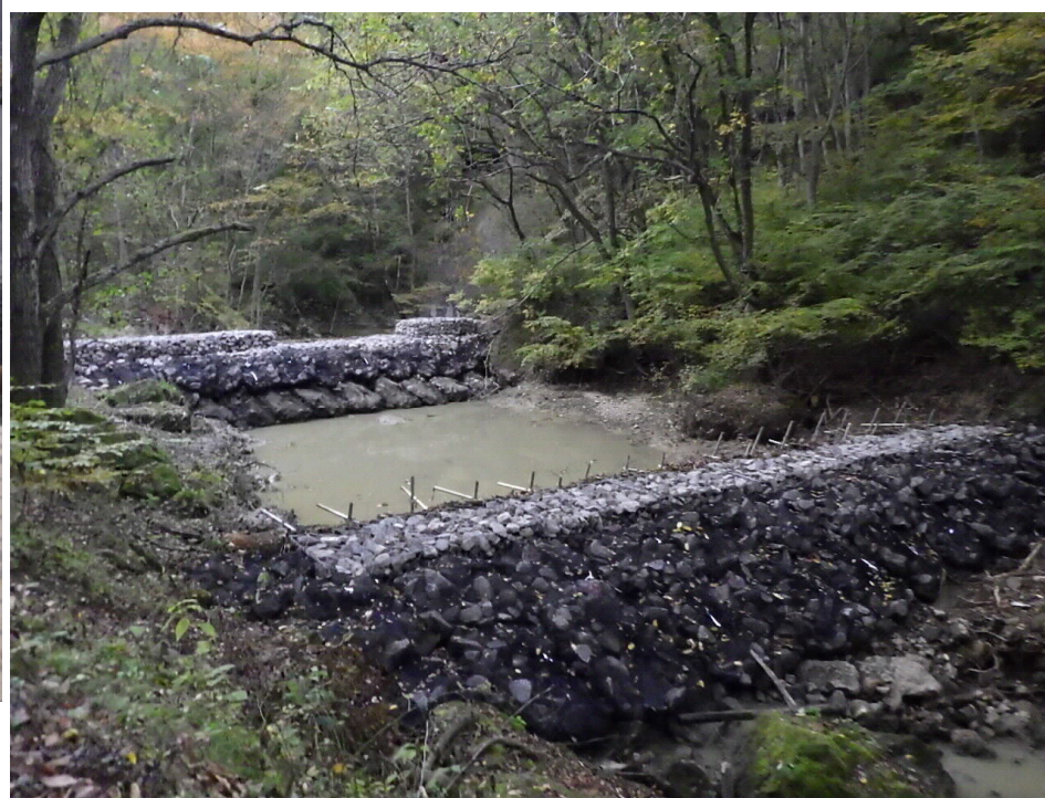
沢山池 濁水処理施設
