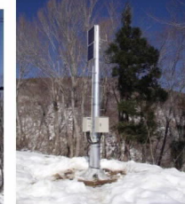
鋼製組立柱を使用した通信局
