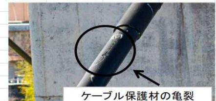
ケーブル保護材の亀裂
