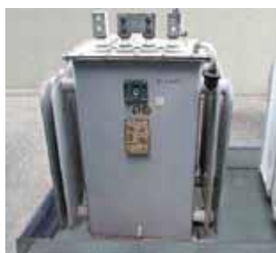
トランス (変圧器)
