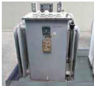
トランス（変圧器）
