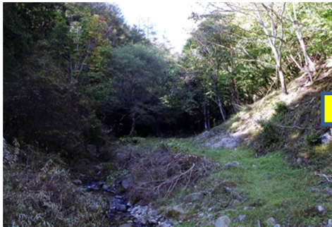
↓ 施工前の荒廃状況
