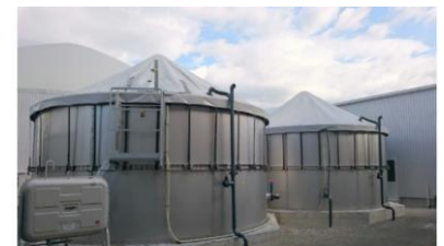
バイオガス発電 中野市
