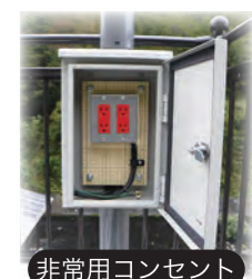
非常用コンセント
