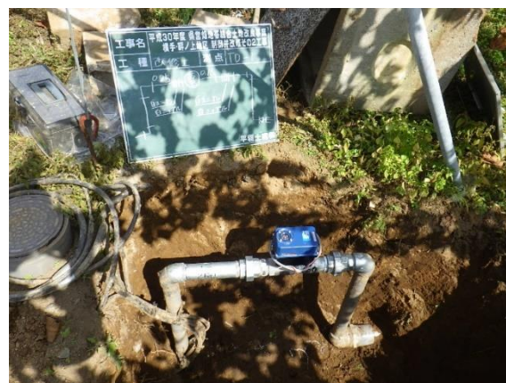
電動弁 (更新後)
