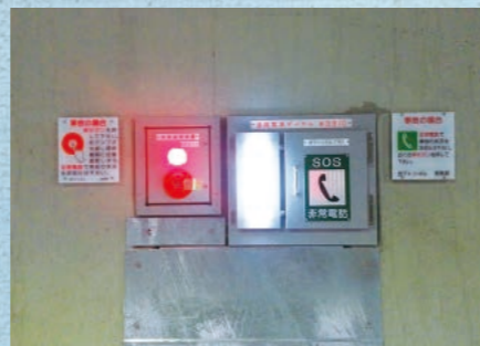
非常用電話設備
