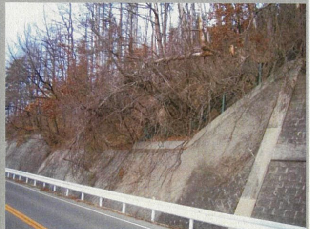
道路沿いの林地で松枯れが拡大しており、強風時や大雨時に国道への倒木が頻繁に発生する。
