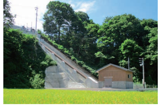
春富水力発電所
