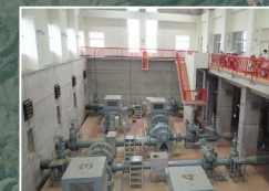
揚水機場内部
