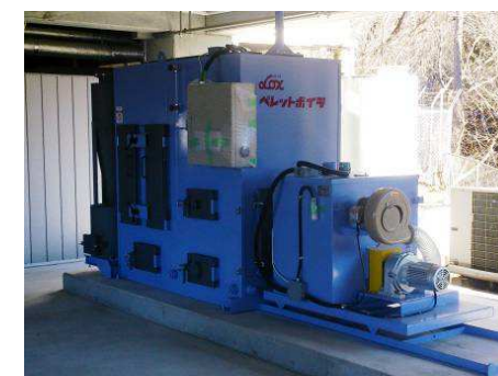
ペレットボイラー
