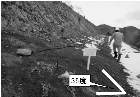
写真1 植栽基盤の状況
