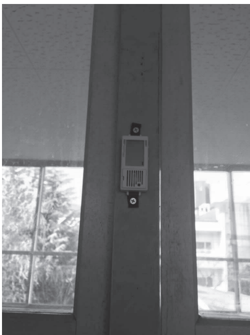
写真1 教室内に設置された温湿度計
