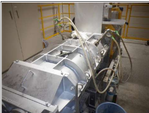
写真 3. 2. 33 飛灰処理装置の様子
