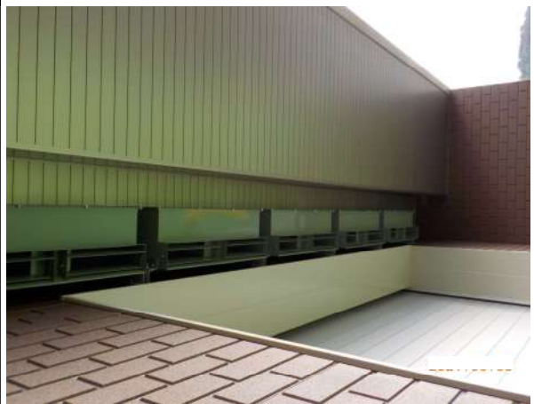
写真 3. 2. 15 エアカーテンの状況
