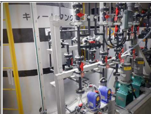
写真 3. 2. 34 安定化剤注入装置の様子
