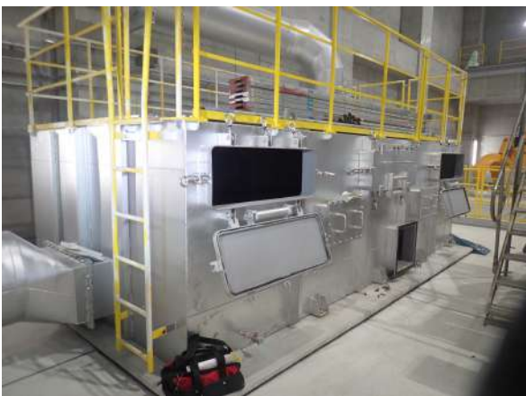
写真 3. 2. 16 活性炭を使用した脱臭装置の様子
