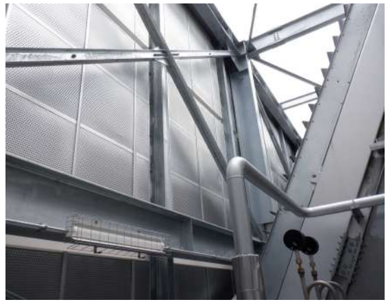
写真 3. 2. 12 排気エリアの様子
