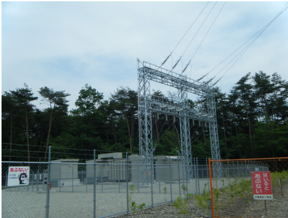
写真 1-6-3 送変電設備及び門型鉄構（イメージ）
