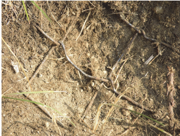
写真 4-2-7 出現した法面保護ネット
