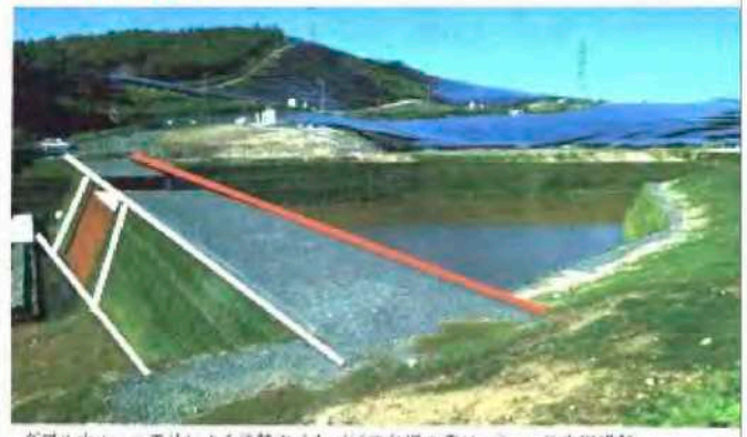
ダブルウォール工法による調整池(メッシュ分銅九重ローラー、養生機埋設)
