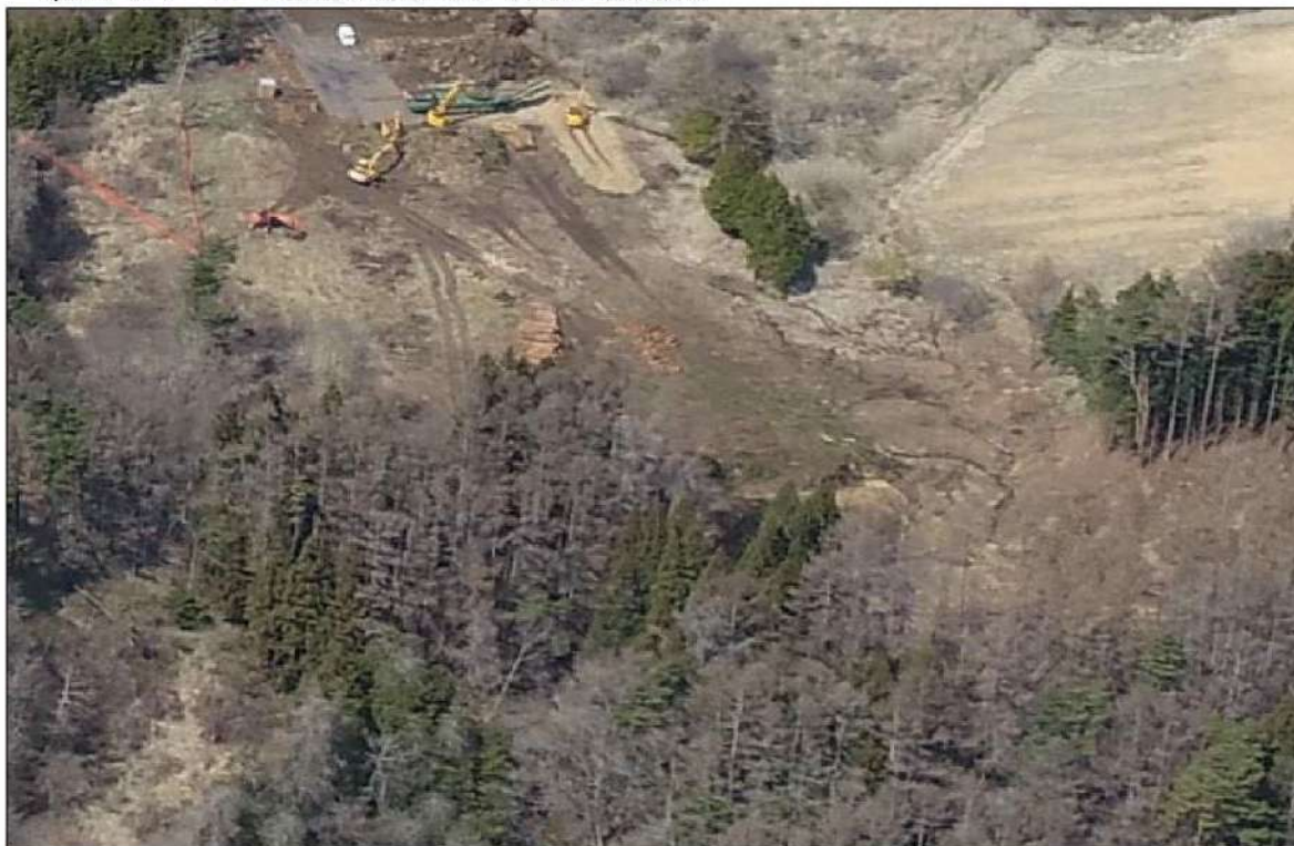
写真 4.3-2(4) 工事の進捗状況写真(チップヤード・No.7調整池まわり：令和5年3月31日時点)
