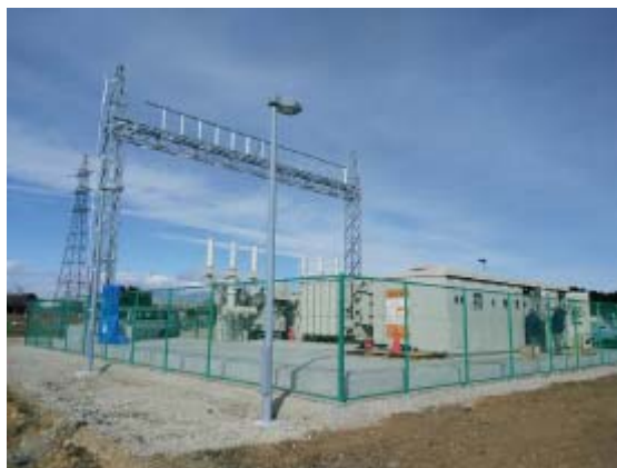
写真1.5-4 二次変圧設備（イメージ）
