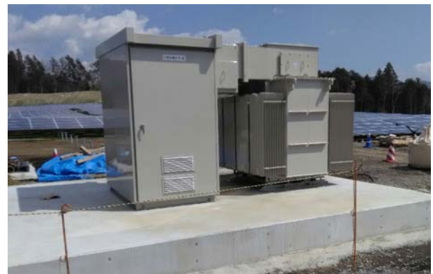
一次変圧設備
