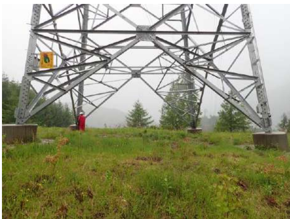
写真7.1-24 (1) 鉄塔敷地の植生状況 (鉄塔③: 令和3年6月)
