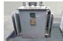
トランス（変圧器）
