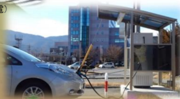
(EVと充電設備)
