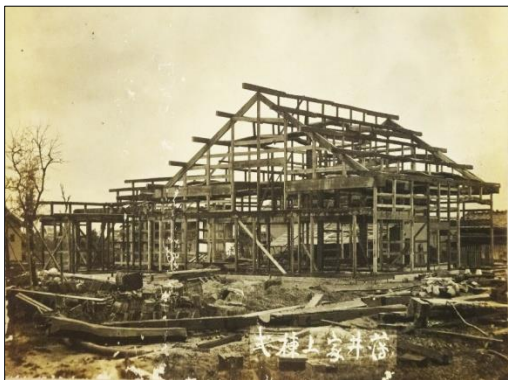
明治末期(約105年前)別の場所から 当地へ移築した際の上棟式(東面)
