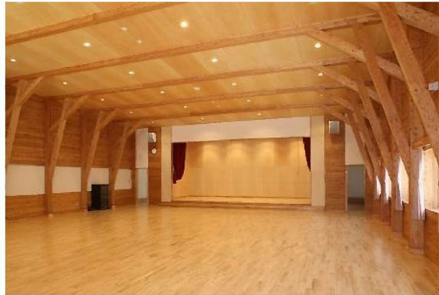
構造材(LVL)を表しにした遊戯室。見付けとなる面を積層面として、より美しさを引き立たせている。
