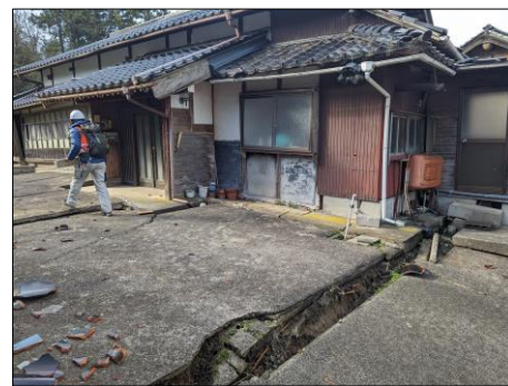
【構造躯体の調査】 地盤の沈下や床、屋根の変形 状況を調べます
