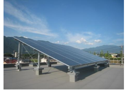
諏訪警察署屋上に設置された太陽光発電設備(諏訪市)
