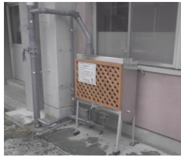
雨水貯留タンク (長野商業高校)
