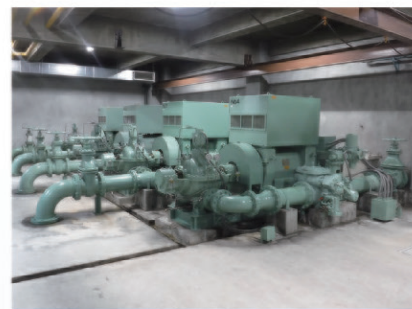
小松原送水ポンプ場(長野市)
