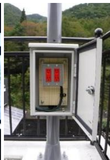
非常用コンセント
