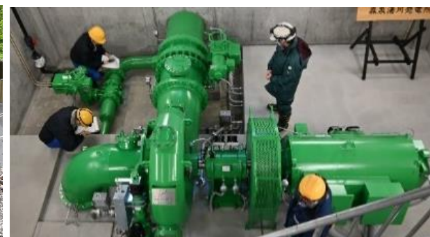
水車発電機の試運転状況
