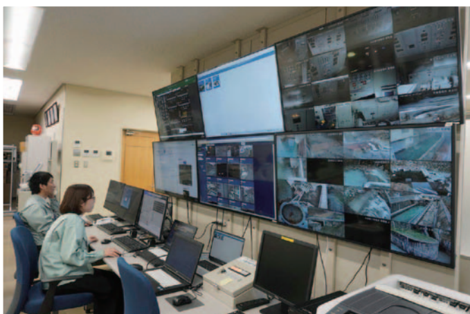
中央制御所での監視制御
