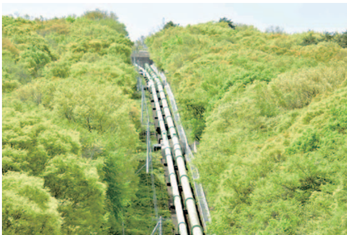
菅平発電所の水圧鉄管（上田市）
