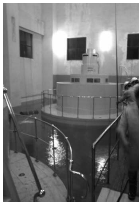
冠水した春近発電所 （発電機固定子まで水没している）
