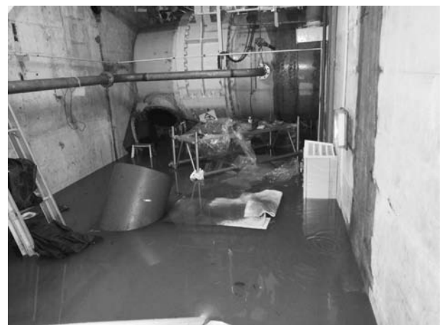
裾花発電所地下室浸水状況
