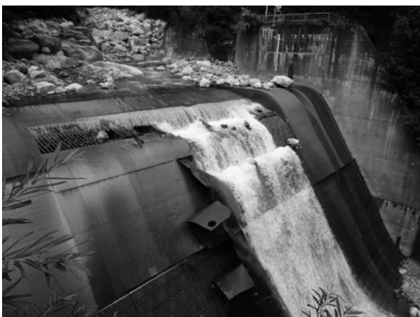
与田切取水口の被災状況
