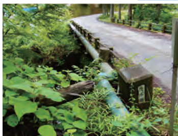
過疎自治体の水道施設の例 (下伊那郡天龍村)
