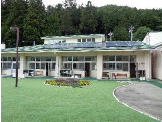
太陽光発電パネル (木曾養護学校)
