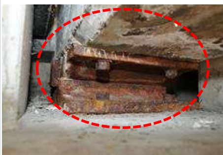
《支承(ししょう)・桁の劣化》 (国)147号 安曇野市 穂高橋
