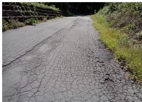
<中山間地域の傷んだ道路>
