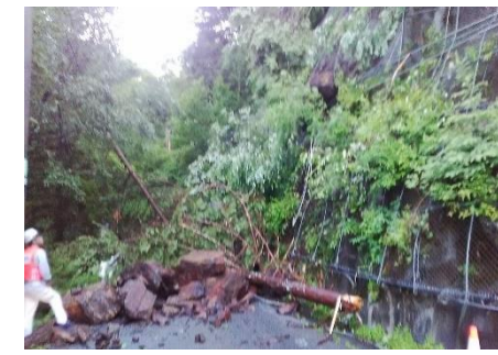
法面崩落による通行止め
