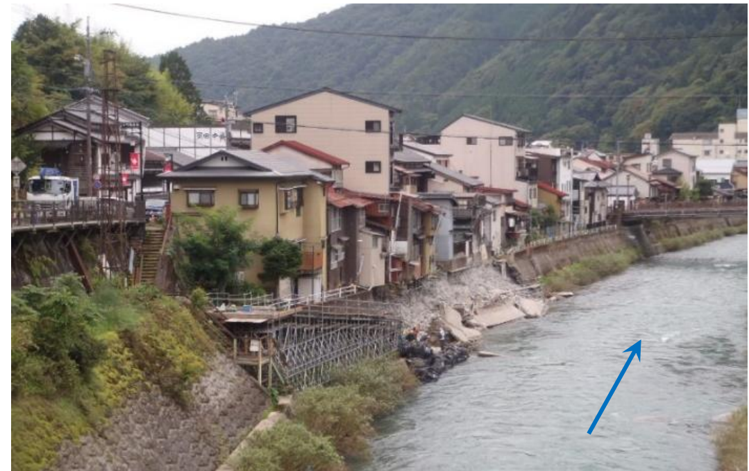
(一) 木曽川 木曽郡木曽町 上町 令和3年8月の大雨により護岸基礎が崩れ、 護岸に沿って並ぶ家屋12棟で倒壊のおそれ
