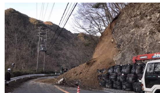
降雨に起因しない法面崩落
