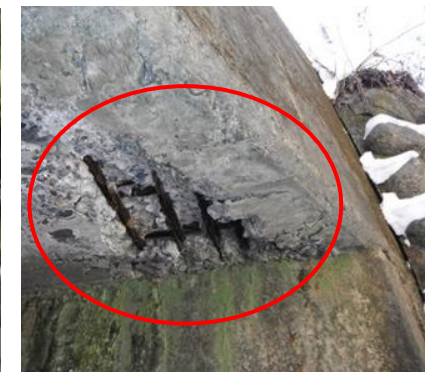
橋梁 床版の剥離・鉄筋露出
