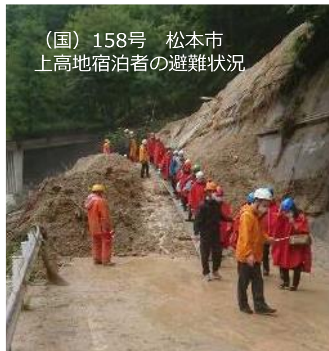
令和2年7月豪雨では、 各地で土砂災害や道路の寸断により集落が孤立 するなど、 地域住民の生活に影響を及ぼした
