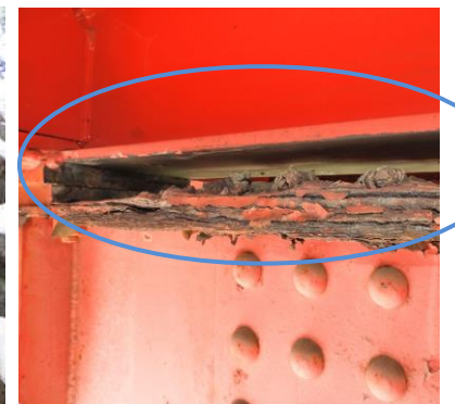
橋梁 桁の腐食
