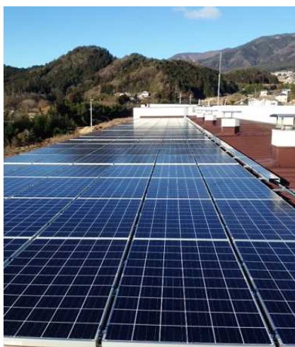
南校舎屋上の216枚の太陽光 パネル 容量 57.24kW
